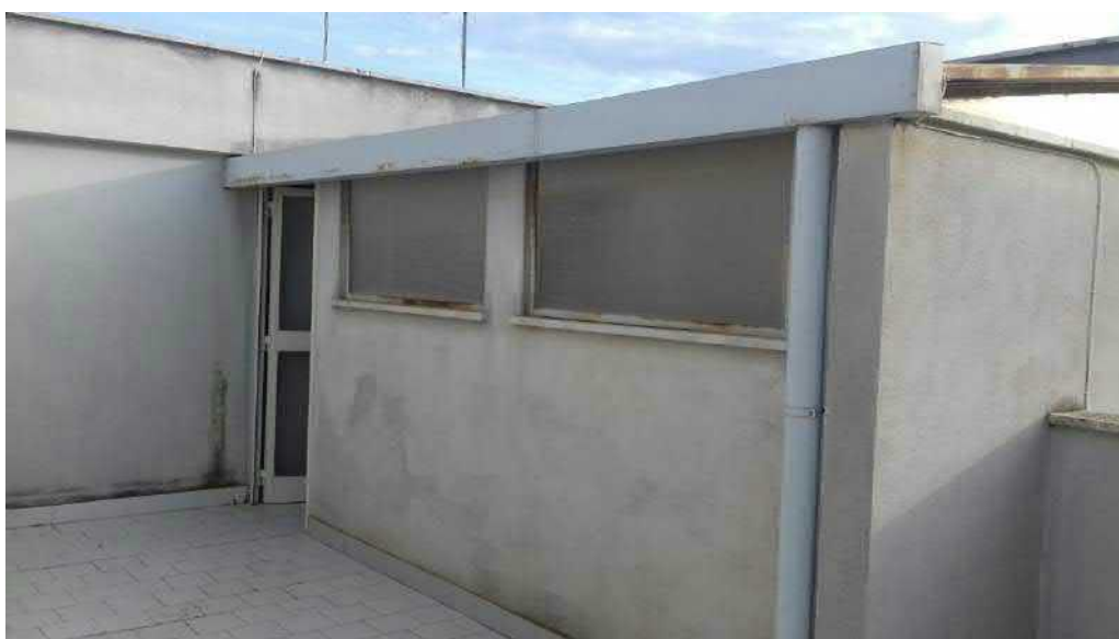
Foto n° 23 – Magazzino realizzato senza titolo sul lastrico solare
